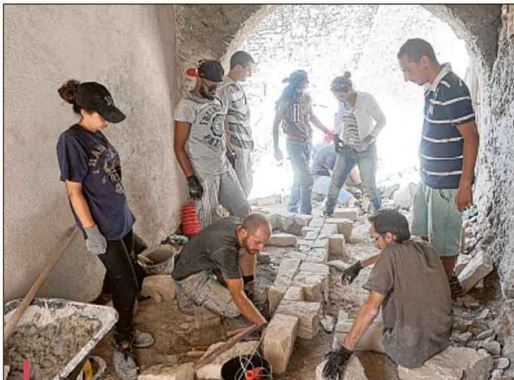
Les bénévoles sur le chantier de la reconstruction de la calade du chemin de ronde.
